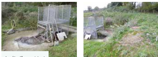
Le dégrilleur existant
